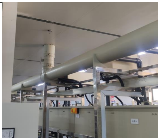
电镀线收集管道
