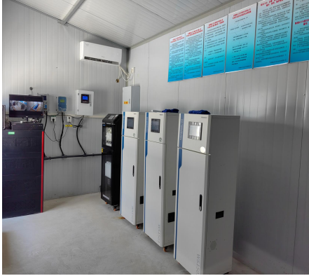
污水总排口在线监测设备
