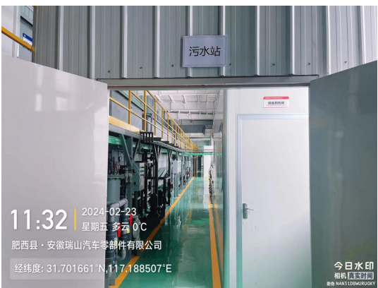
厂区污水处理站
