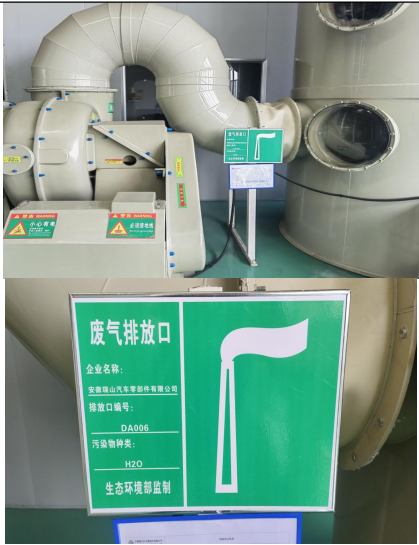
DA006 排放口标识牌
