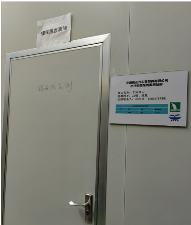
车间排放口在线监测设备站房
