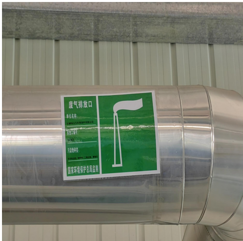
DA003 排放口标识牌
