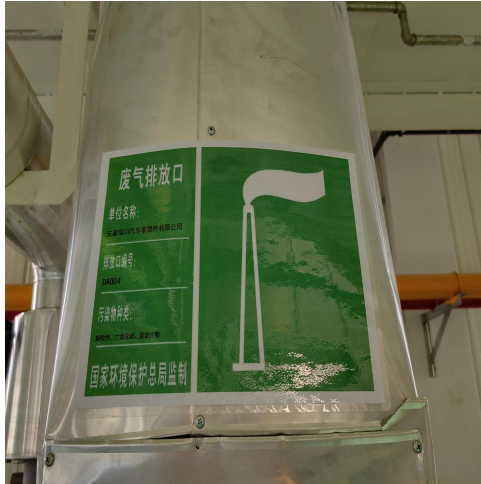
DA004 排放口标识牌
