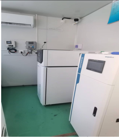
车间排放口在线监测设备
