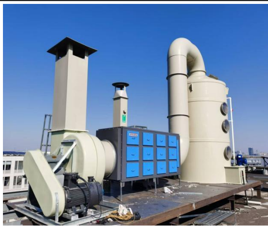
催化剂配制废气处理设施 (水喷淋+一级活性炭吸附装置)
