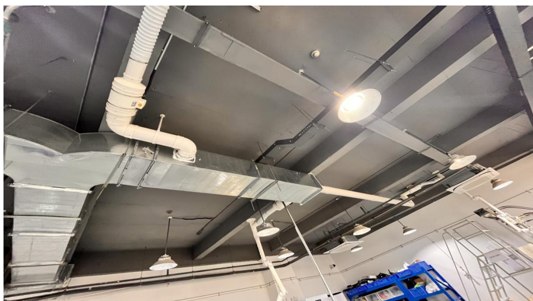
加工测试实验室废气收集管道
