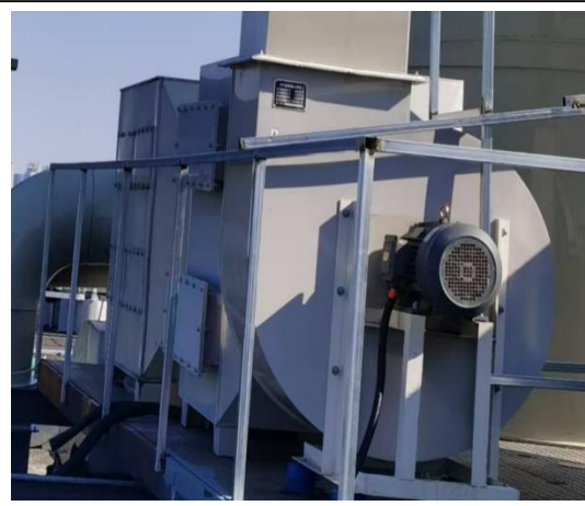
高温有机废气处理设施(二级活性炭吸附)
