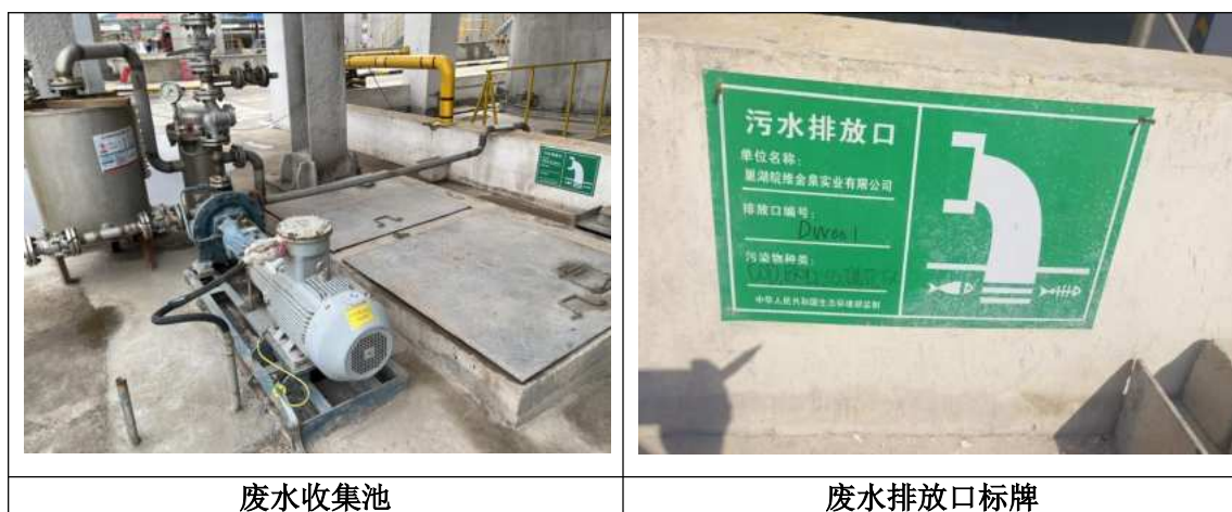
图 4.1-2 废水收集池及标牌
