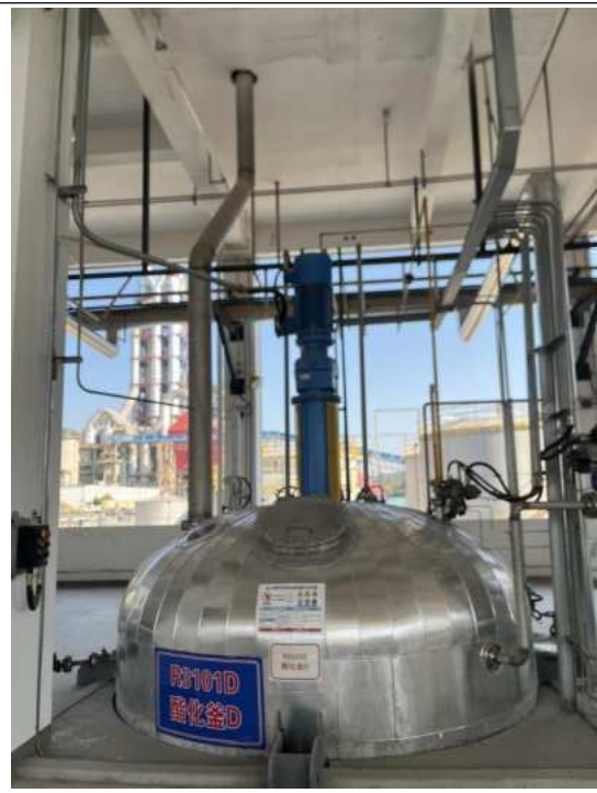
酯化釜及废气收集管线
