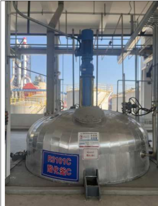
酯化釜及废气收集管线
