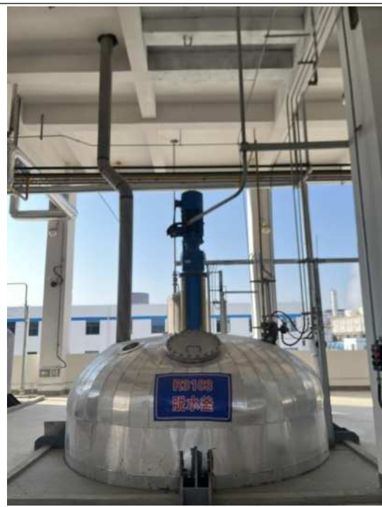
脱水釜及废气收集管线
