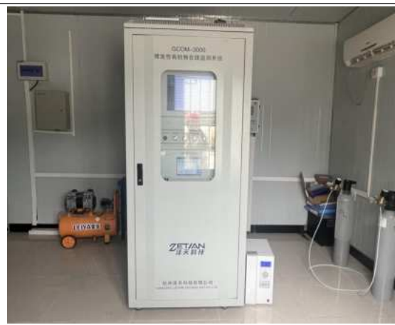
废气在线监测系统
