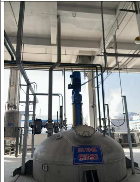
精滤釜及废气收集管线
