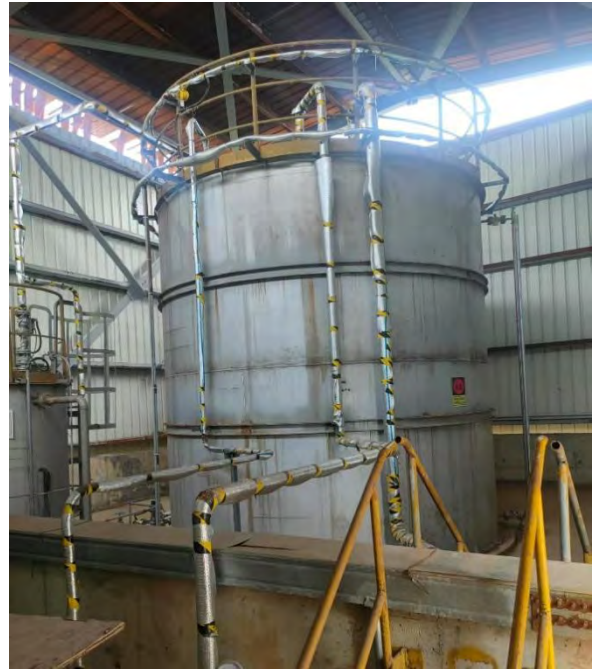
液氨储罐及围堰
