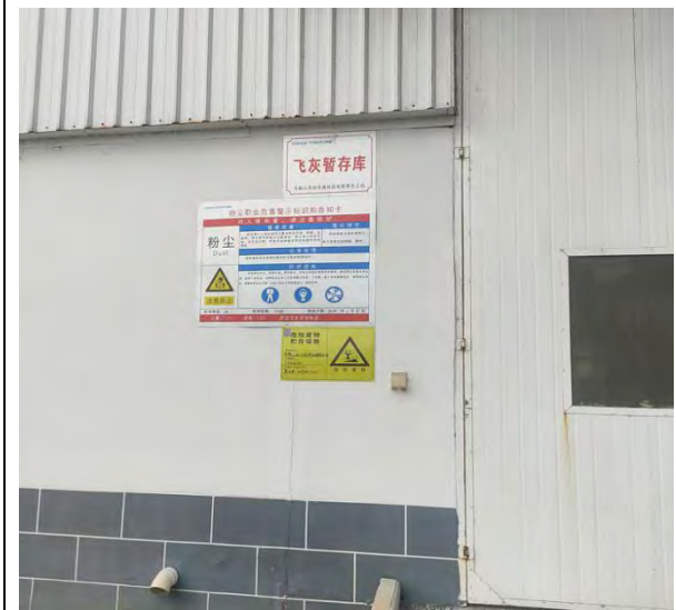
飞灰暂存间标识牌
